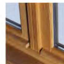
Détail de la partie centrale et des jets d'eau.
